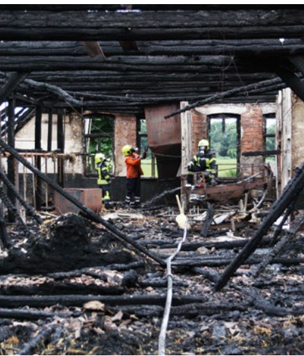
Außer verkohlten Balken und Schutt blieb nicht viel von diesem Stall übrig.
